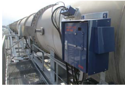
工場に設置されている白濁排ガス用ダスト濃度計
